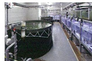
予備水槽室(バックヤード)
