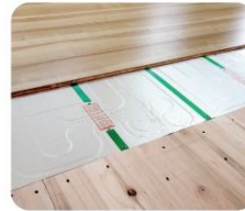
床暖房 ●部分的に温まらない ●温度調節ができない
