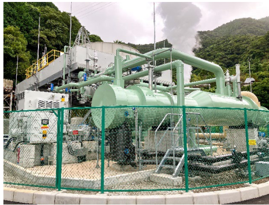
「杉乃井地熱発電所」
